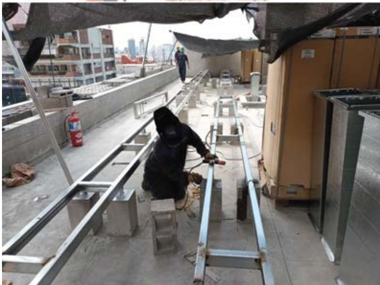
Piso 16 Terraza técnica, equipos de AA
