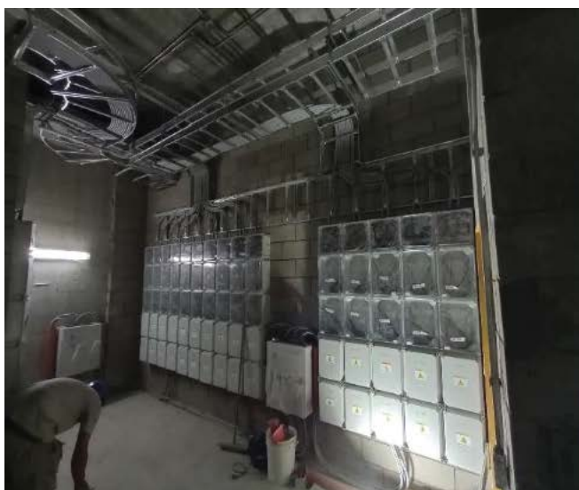
Sala de medidores eléctricos
