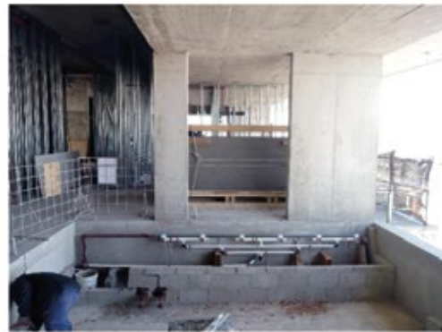
Instalación sanitaria para el funcionamiento del jacuzzi
