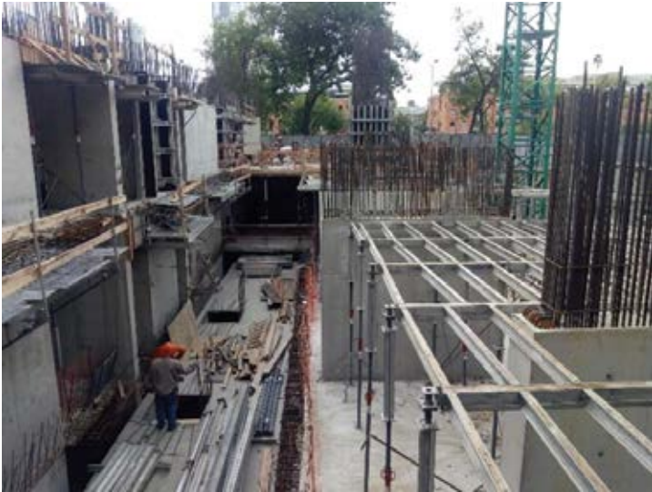
Se puede ver el entramado s/1ss y la tapa del tanque de impulsión.
